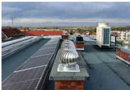
Instalacje OZE na dachu budynku przy ul. Żeromskiego
